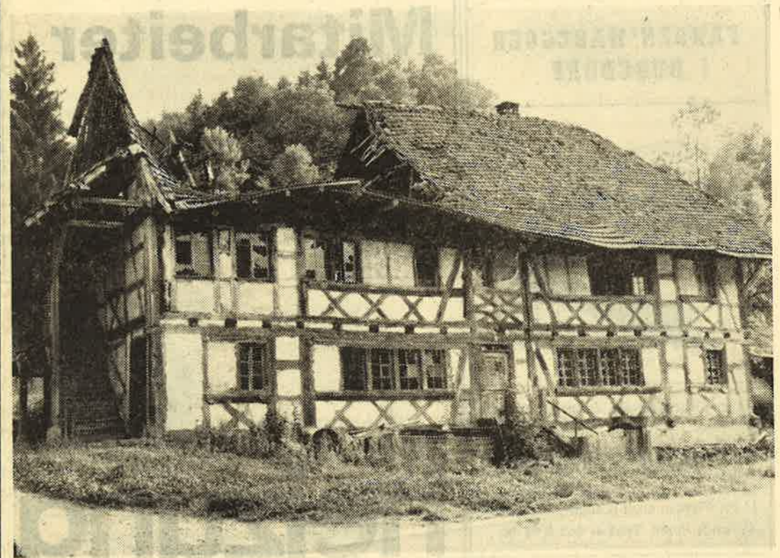
Das schönste und echtste Aargauer Riegelhaus ist zerfallen. Das in Etwil, Gemeinde Leuggern im Fricktal, stehende Gebäude war vor einem Jahr noch bewohnt. Heute hausen hier die Marder. Niemand hat sich für die Erhaltung dieser wertvollen bäuerlichen Baukunst eingesetzt. (Aufnahme: Roland Beck)
